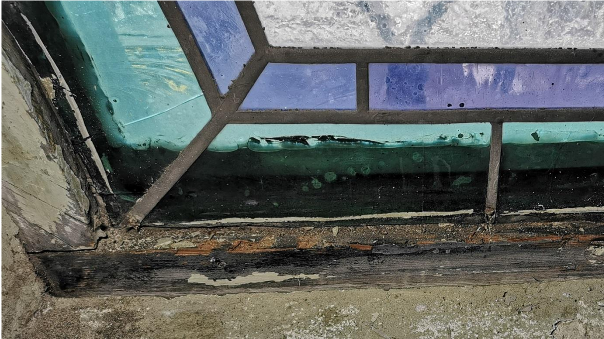
Fenster nV während dem Ausbau: In manchen Bereichen der Fenster ist kein Randblei vorhanden
