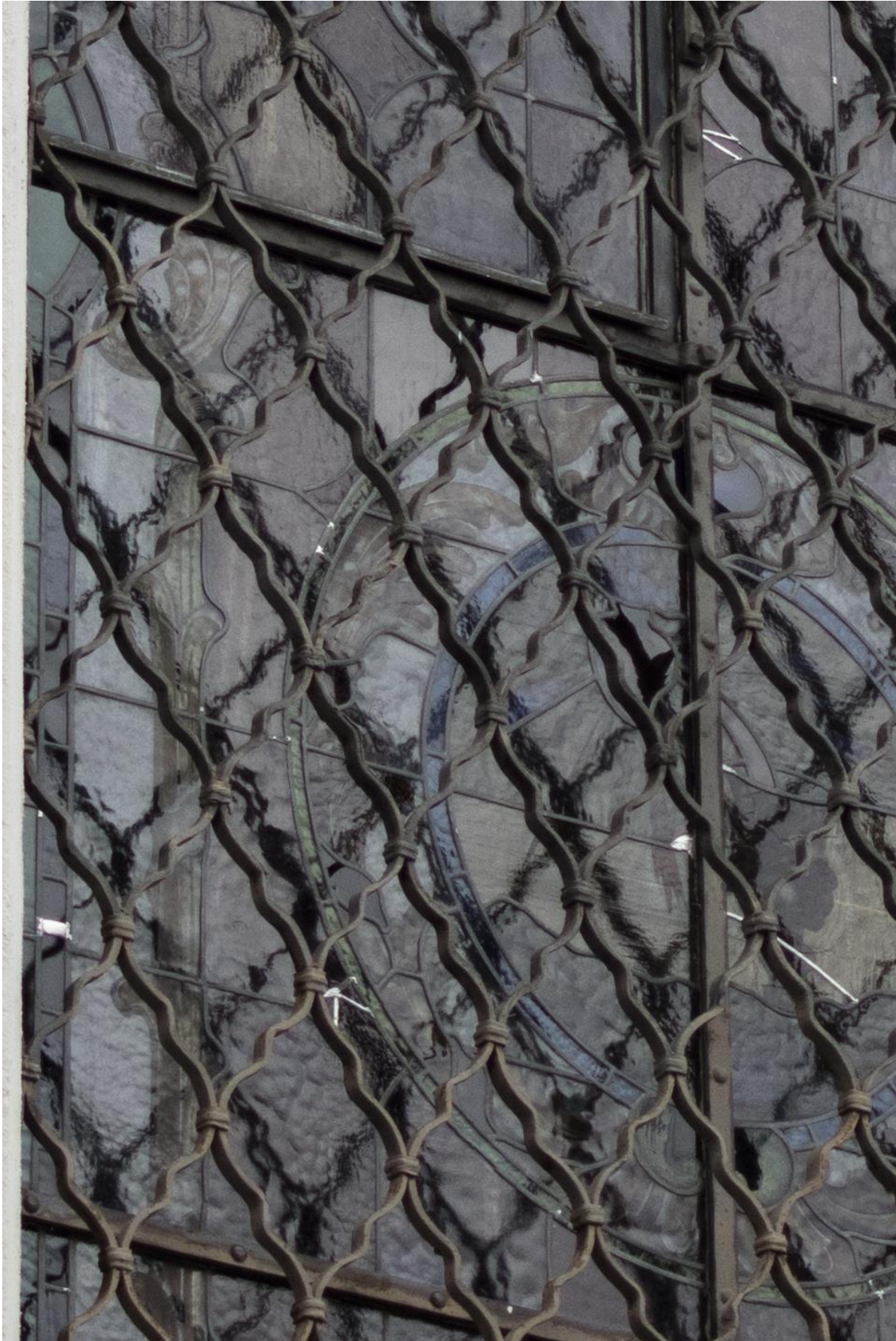
Fenster sIII: Mit Sprungblei versehene Glasbrüche wie auch neu-verlötete Lötstellen von außen nach dem Wiedereinbau
