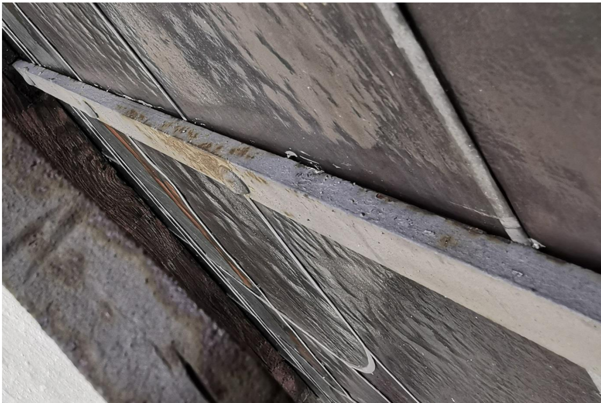
Oberkante Quereisen (vor der Restauration) außen bei Fenster nV, es ist kein Kitt sichtbar
