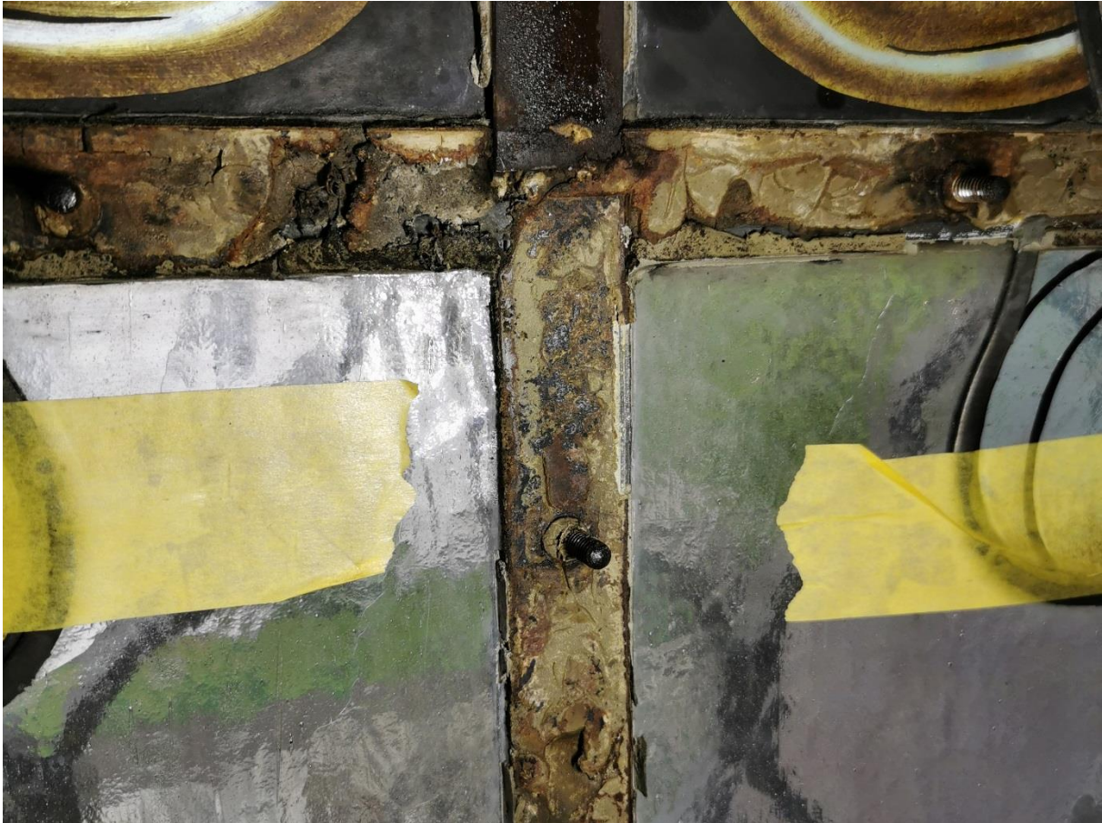
Ebenfalls geöffnetes Quereisen innen bei Fenster nIII, hier wurde hingegen viel Kitt eingebracht
