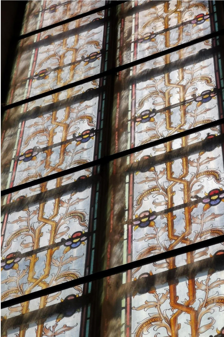
Fenster sl mit falsch konstruierter Floatglas-Fixverglasung auf der Innenseite
